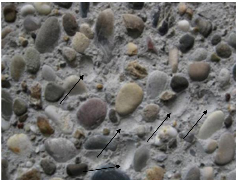
Rysunek 7. Efekt zbyt wczesnego rozpoczęcia eksponowania kruszywa - widoczne niepożądane ubytki
