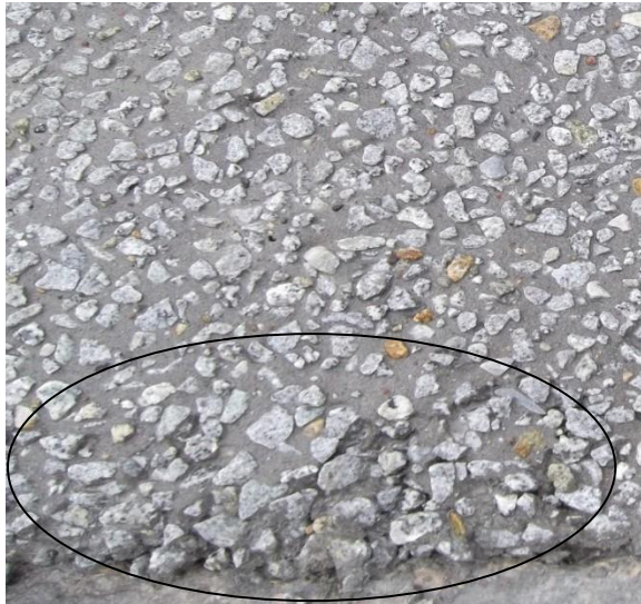
Rysunek 4. Pozostawione podczas wygładzania "niedomknięte" fragmenty nawierzchni skutkują powstawaniem znacznych ubytków zaprawy, co skutkuje pogorszeniem estetyki nawierzchni i obniża jej trwałość.
